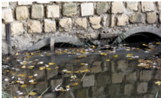
Un pod vechi peste râulețul Știubei pe Drumul Vechi Moldovenesc An old bridge over the Stiubei stream on the Old Moldavian Road
